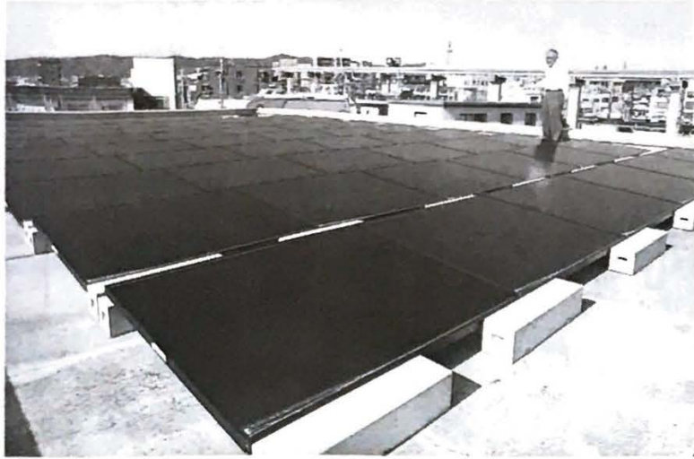
「あつぷるこども園」の屋上に設置された太陽光発電パネル ル＝豊中市蛍池中町3丁目
